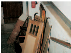
Fatal im Brandfall: abgestellter Sperrmüll in Fluchtwegen.
